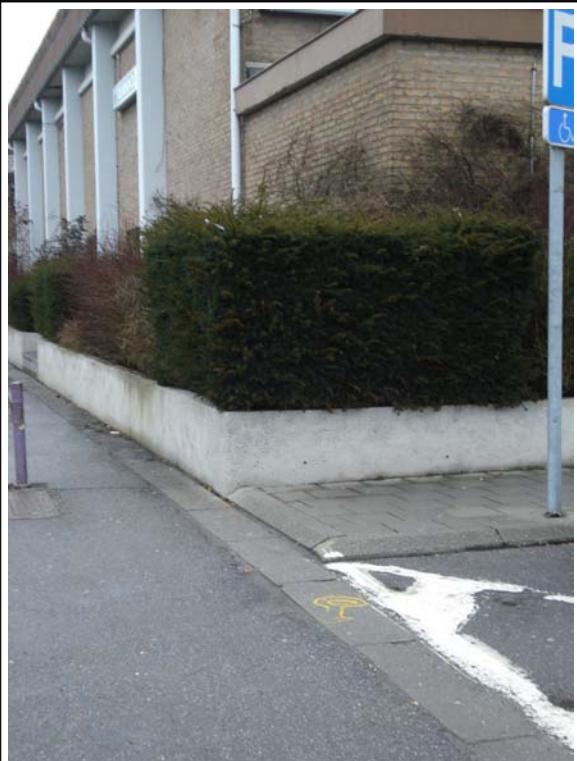
Photo 2: Bordures avec inflexions insuffisantes
