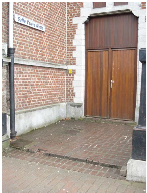
Photo 4: Entrée principale avec marche endommagée sans inflexion de bordure.
