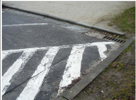
Photo 4: Revêtement de sol irréguliers, pas d'inflexions de bordures
